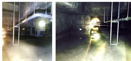
▲水産卸売場棟地下は、所々水たまりがある程度
